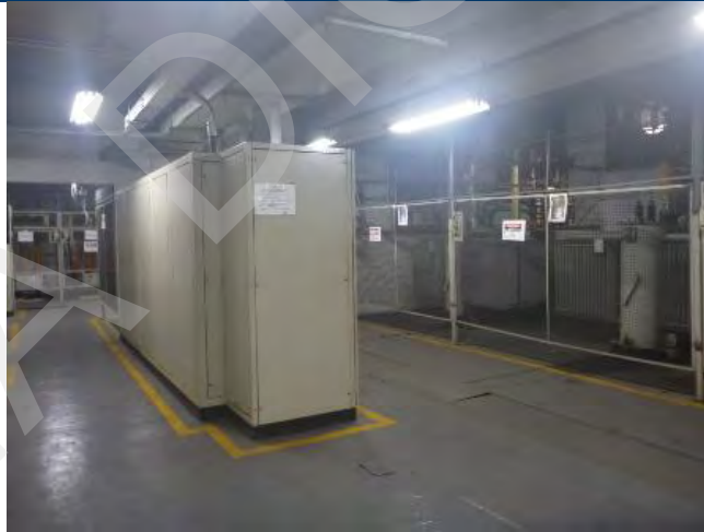
ASPECTO INTERNO – PISO G1 – ÁREA TÉCNICA
